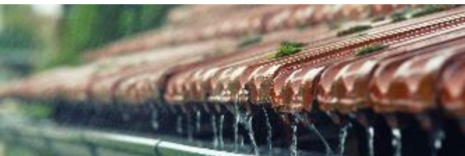
Eaux de pluie des toitures inaccessibles
