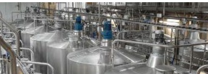
Eaux industrielles des industries agroalimentaires (contact alimentaire)
